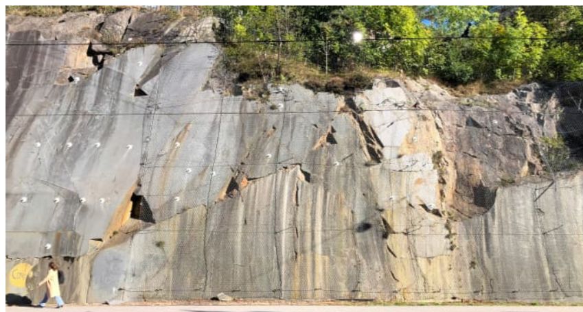
Figur 95. Foto av sågad bergskärning söder om Kapellplatsen. Exempel på hur berget vid entré mot E45/Oscarsleden kan hanteras för en ordnad stadsbild mot cykelstråket (AFRY, 2025).
